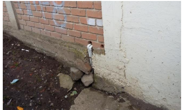
Exterior donde vierten residuos
